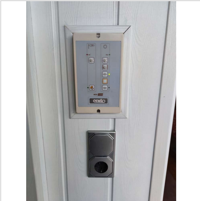
Steuerung Markise WG EG
